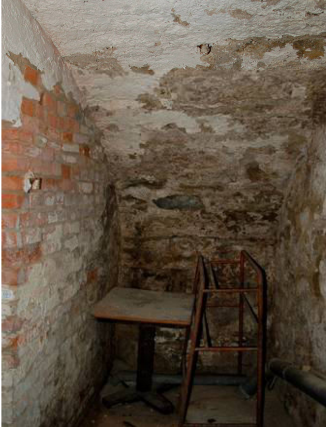
Abb. 7 Friedrichstraße 74, östlicher Keller. Blick durch den Vorraum den südseitigen Treppenabgang nach Osten auf die östliche Längswand.
