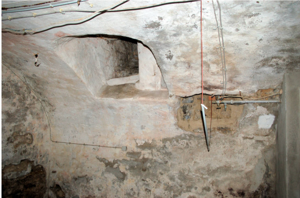
Abb. 24 Friedrichstraße 76, Gewölbekeller. Blick auf den östlichen abschnitt der Südwand mit schmalen Luftschacht in der Gewölbeschale.
