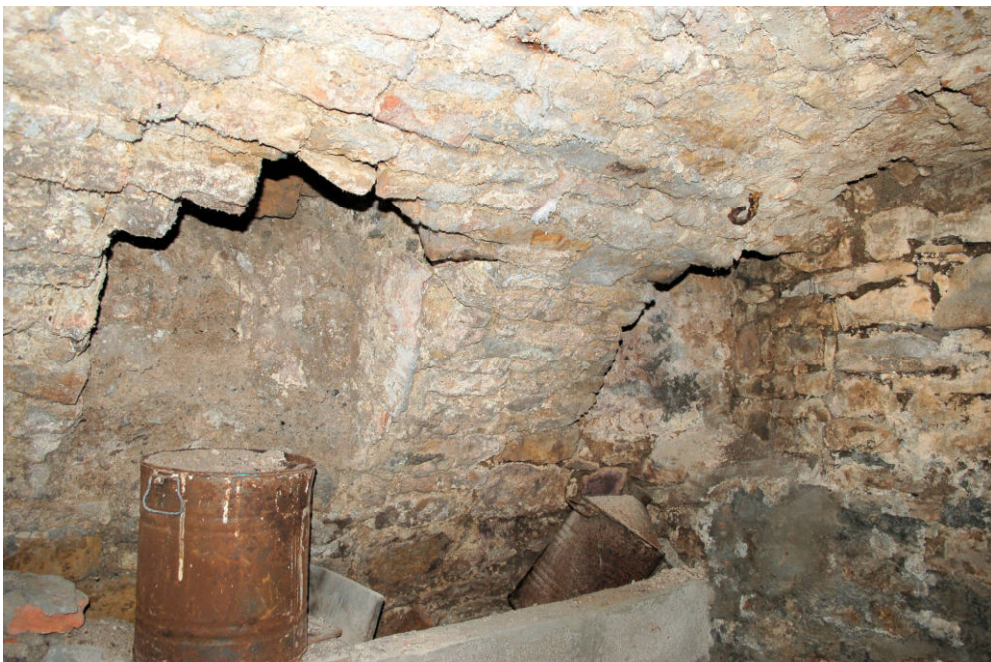
Abb. 38 Schwanenstraße 5, Gewölbekeller. Westlicher Abschnitt der Südwand des westlichen Kellers mit zwei nachträglich eingebrochenen, heute wieder vermauerten Luftschächten.
