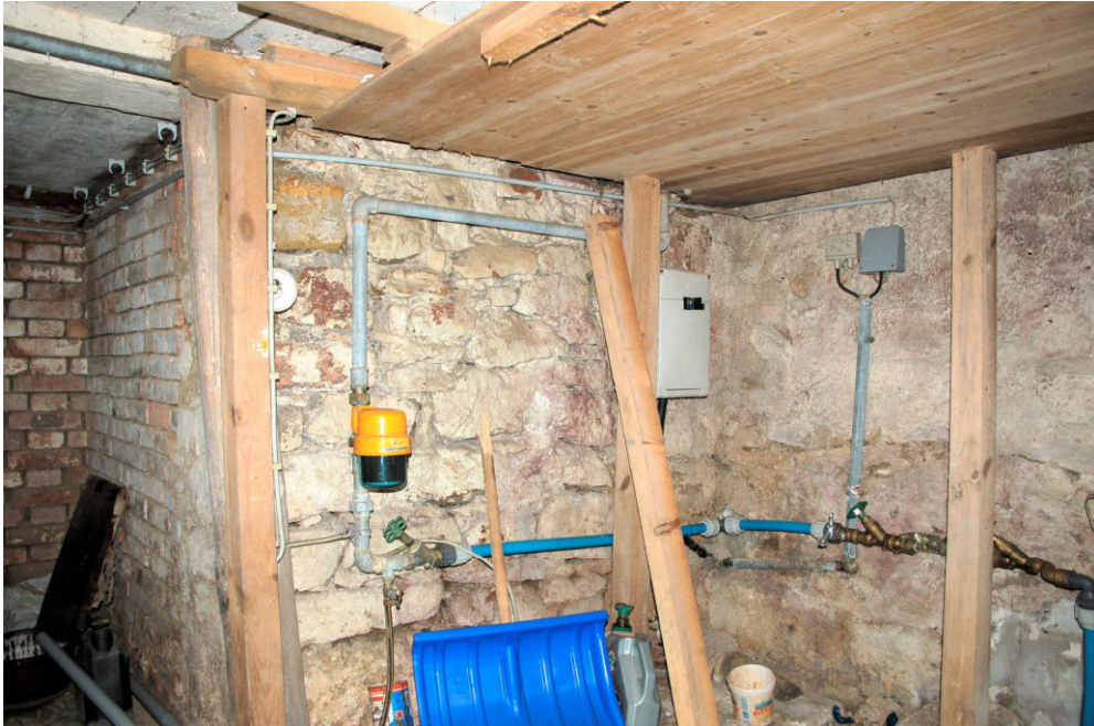
Abb. 40 Schwanenstraße 7, Keller. Blick auf den westlichen Teil der Westwand, links der Eingang zum Treppenabgang aus dem Erdgeschoß mit seinem modernen Backsteinmauerwerk.
