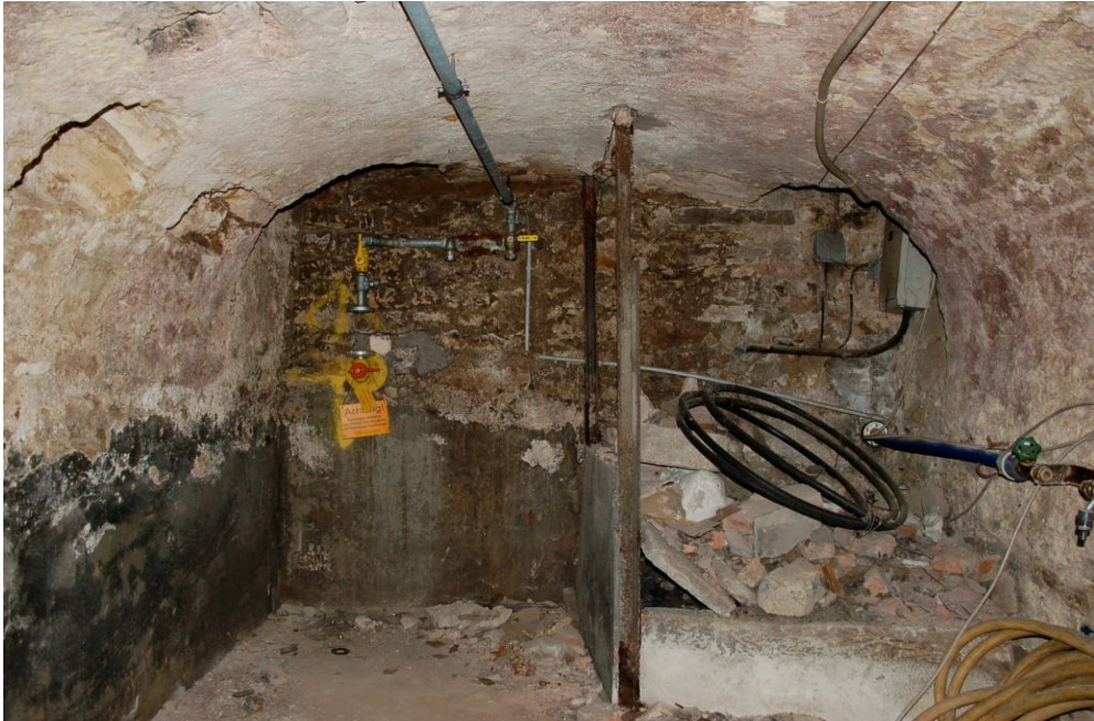
Abb. 30 Schwanenstraße 5, Gewölbekeller. Blick nach Norden in den nordöstlichen Keller, in der Bildmitte die nördliche Stirnseite mit ihren beiden seitlichen Luftschächten. In der Gewölbeschale links zwei nachträgliche Ausbrüche für Balkenaufleger. Gut zu erkennen ist die nur sehr flache, korbboigige Einwölbung des Raumes.
