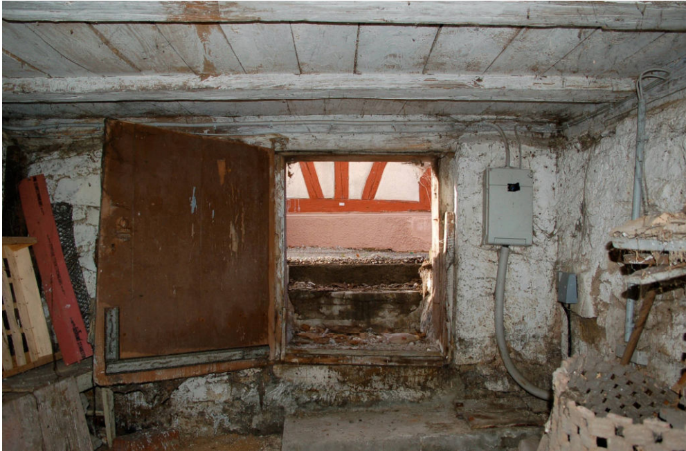
Abb. 48 Schwanenstraße 9, Keller. Blick nach Westen auf die westliche Stirnwand mit der Eingangsöffnung.
