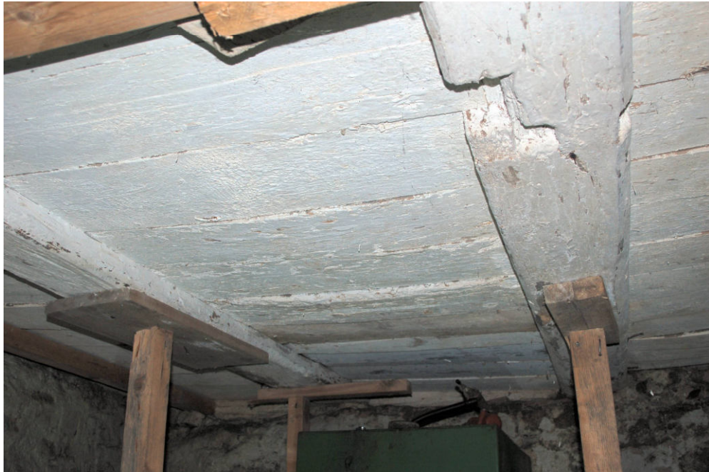
Abb. 43 Schwanenstraße 7, Keller. Deckengebälk mit eingetretetem Fehlboden aus Nadelholz.
