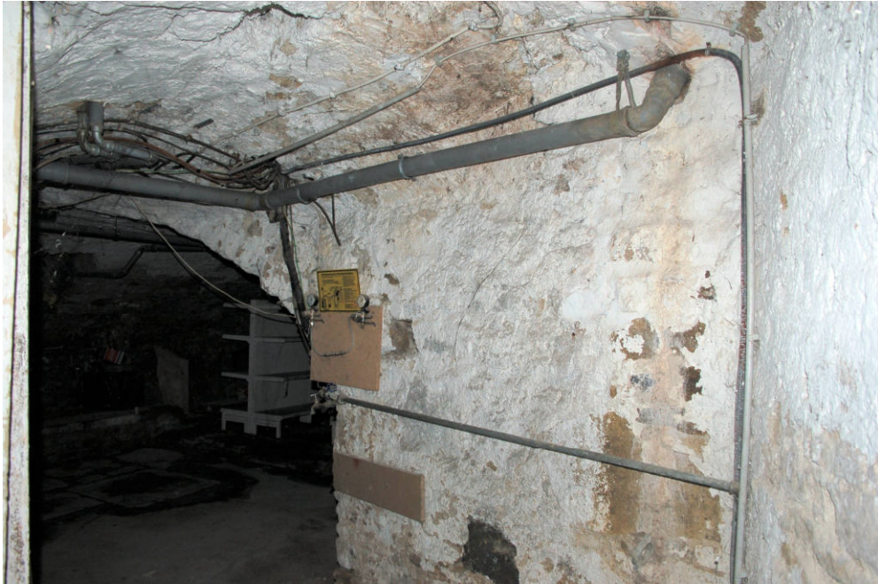
Abb. 11 Friedrichstraße 74, westlicher Keller. Blick durch den Kellerzugang nach Nord- westen, hin zum Hauptkeller.
