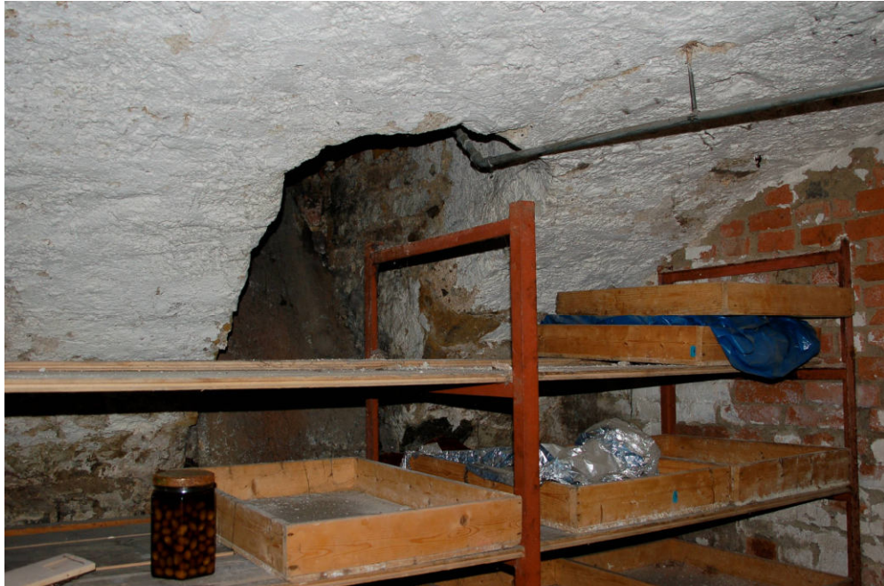
Abb. 4 Friedrichstraße 74, östlicher Keller. Blick auf den südlichen Luftschacht der öst- lichen Längsseite.
