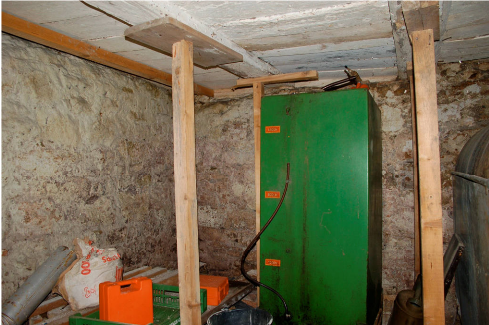
Abb. 42 Schwanenstraße 7, Keller. Blick nach Südosten in die Südostecke des Keller- raumes mit homogenem Bruchsteinmauerwerk und Nadelholzdeckengebälk mit eingenuteten Fehlbodenbrettern.
