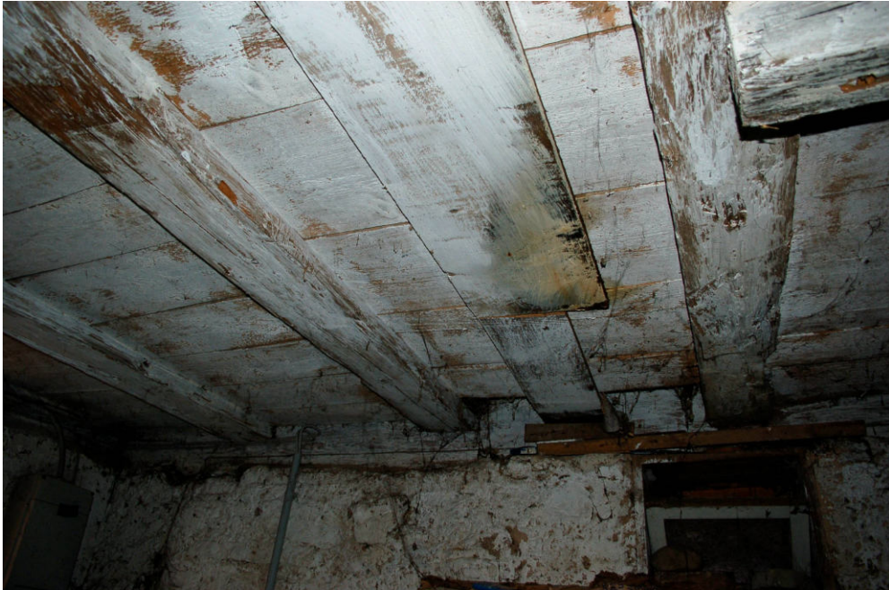
Abb. 51 Schwanenstraße 9, Keller. Nadelholzdeckengebälk mit eingenu tetem Fehlboden aus breiten Nadelholzbrettern im westlichen Deckenbereich
