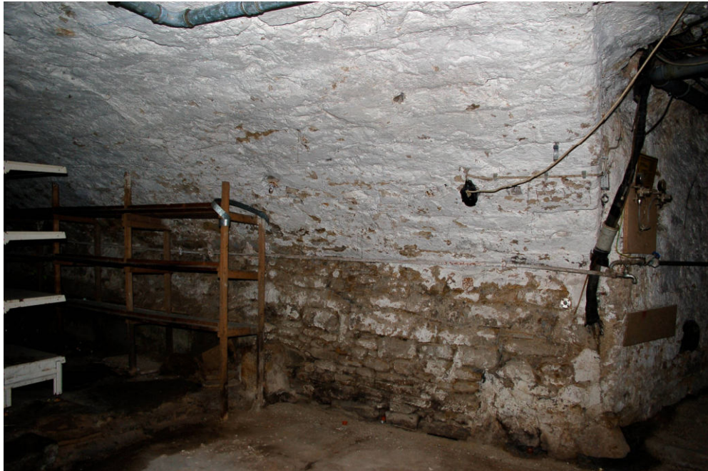
Abb. 13 Friedrichstraße 74, westlicher Keller. Blick auf den mittleren Teil der östlichen Längswand mit dem Übergang zum Zugang.
